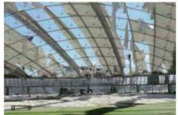
▲雪の重みで屋根が破れた熊谷ドーム
