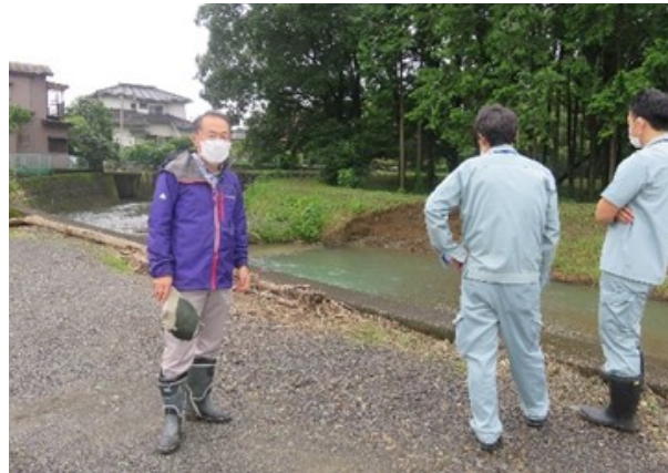
▲毛呂川の護岸崩壊箇所(毛呂山町平山地区)
